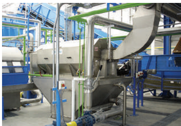
Filtrazione acqua Water filtration
