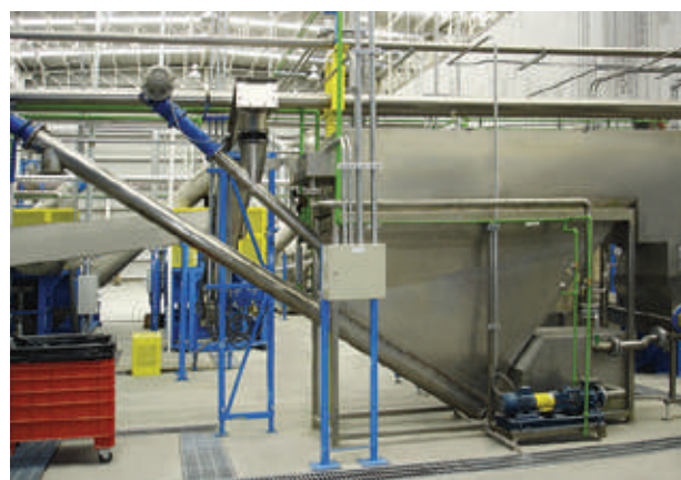
Vasca di purificazione delle poliolefine Polyolefin purification trough
