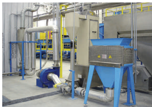
Essiccazione Drying system
