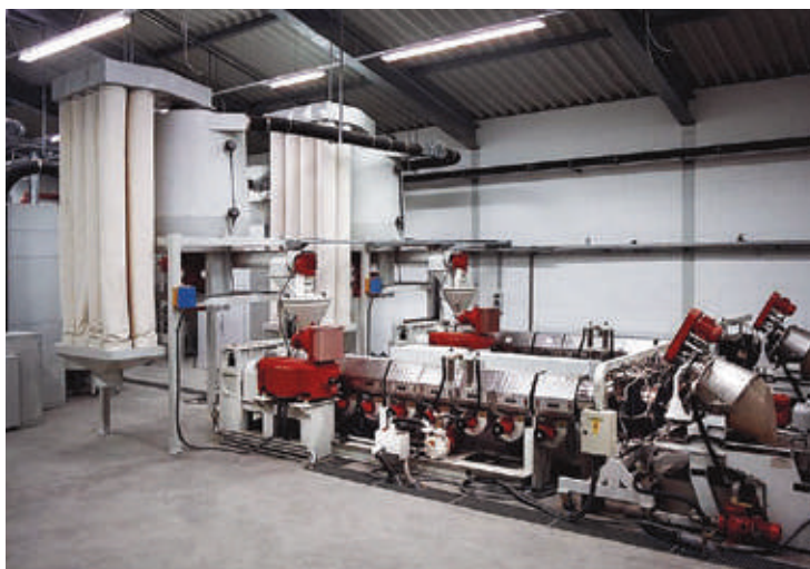
Linea di granulazione Pelletizing line
